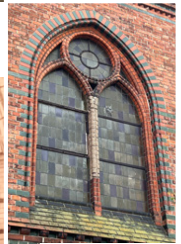
Schadbild eines Fensters auf der Nordseite.
