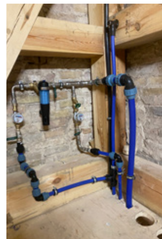
Absperr- und Messeinrichtung des Wasseranschlusses im Kirchturm der Alten Dorfkirche für die Verteilung des Wassers zu den Kirchen und zum Friedhof.
